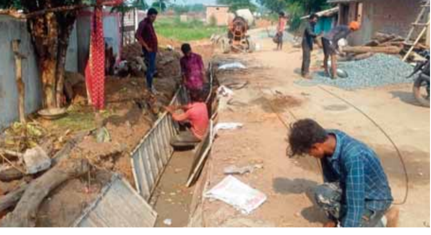
ब्योहारी अंतर्गत ग्राम पंचायत सरवाही कला में नाली निर्माण कार्य में भारी अनियमितता की जा रही है। जिसमें निर्माण कार्य में घटिया सामग्री से निर्माण कार्य किया जा रहा है। गांव के लोगों ने आवाज उठाई लेकिन इंजीनियर द्वारा मौके पर जाकर
